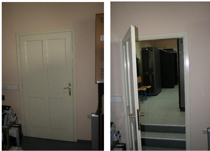
Sl. 16. Ulaz u serversku sobu iz skladišta informatičke službe [14]
