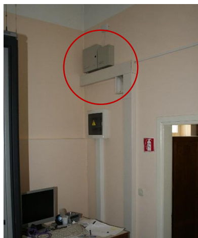
Sl.23. Vatrodjavna centrala u serverskoj sobi [14]
