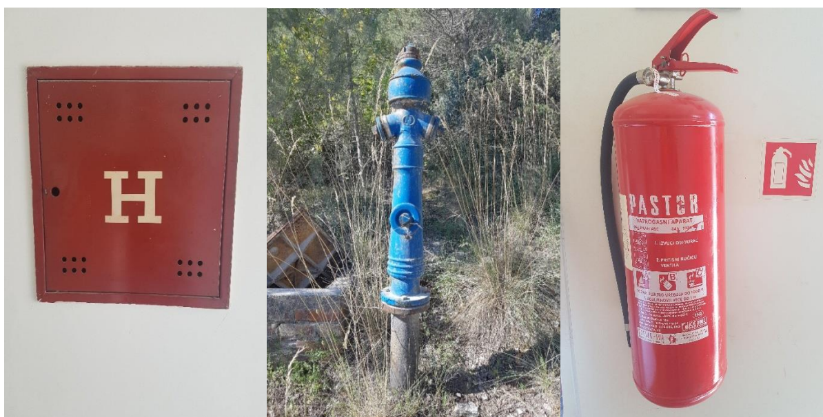
Sl. 3. Zidni i nadzemni hidrant, vatrogasni aparat
