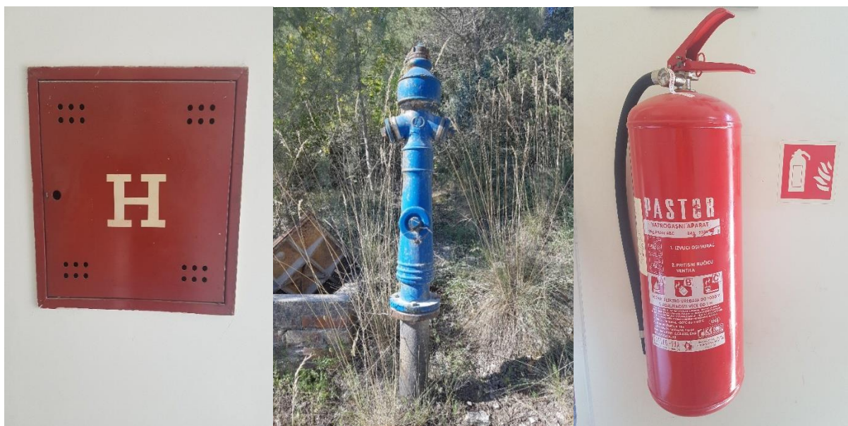
Sl. 3. Zidni i nadzemni hidrant, vatrogasni aparat
