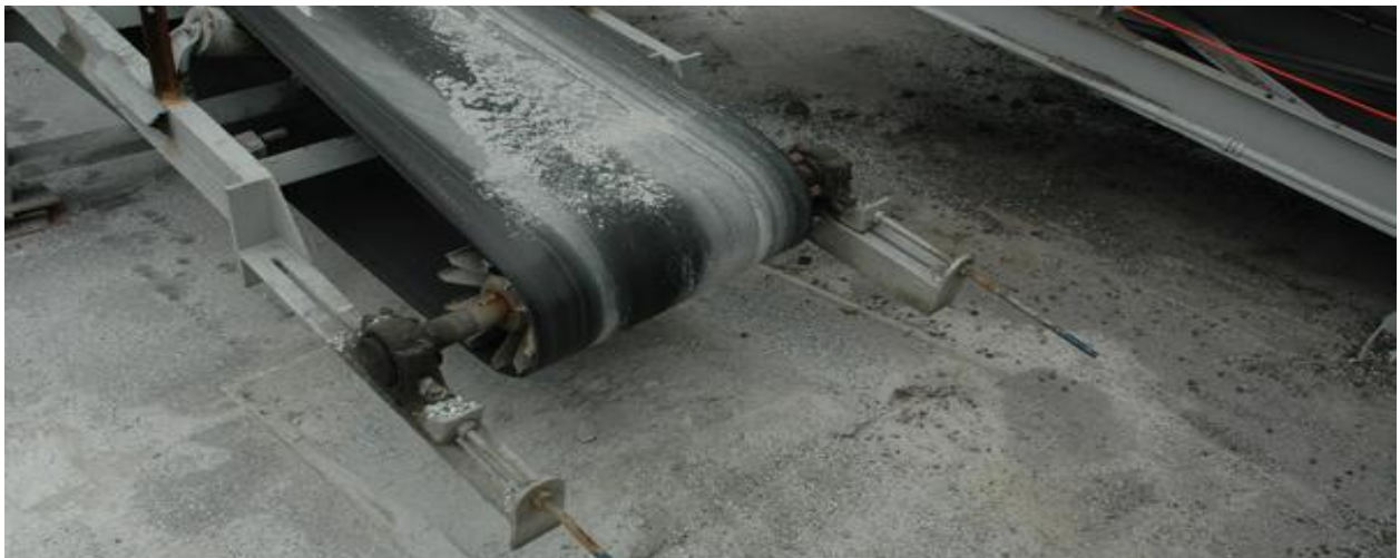
Sl.21. Primjer trakastog transportera na kakvom je došlo do ozljede sa smrtnim posljedicama
