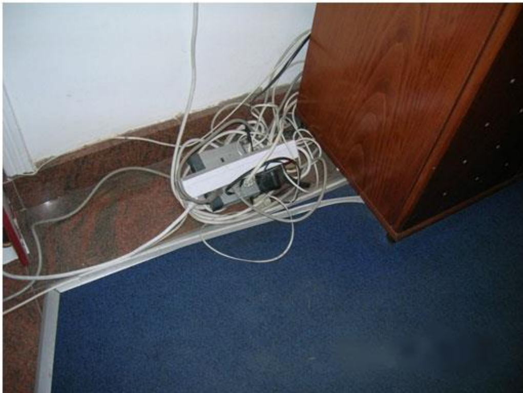
Slika 1: Prikaz neispravno priključenih produžnih kablova [12].
