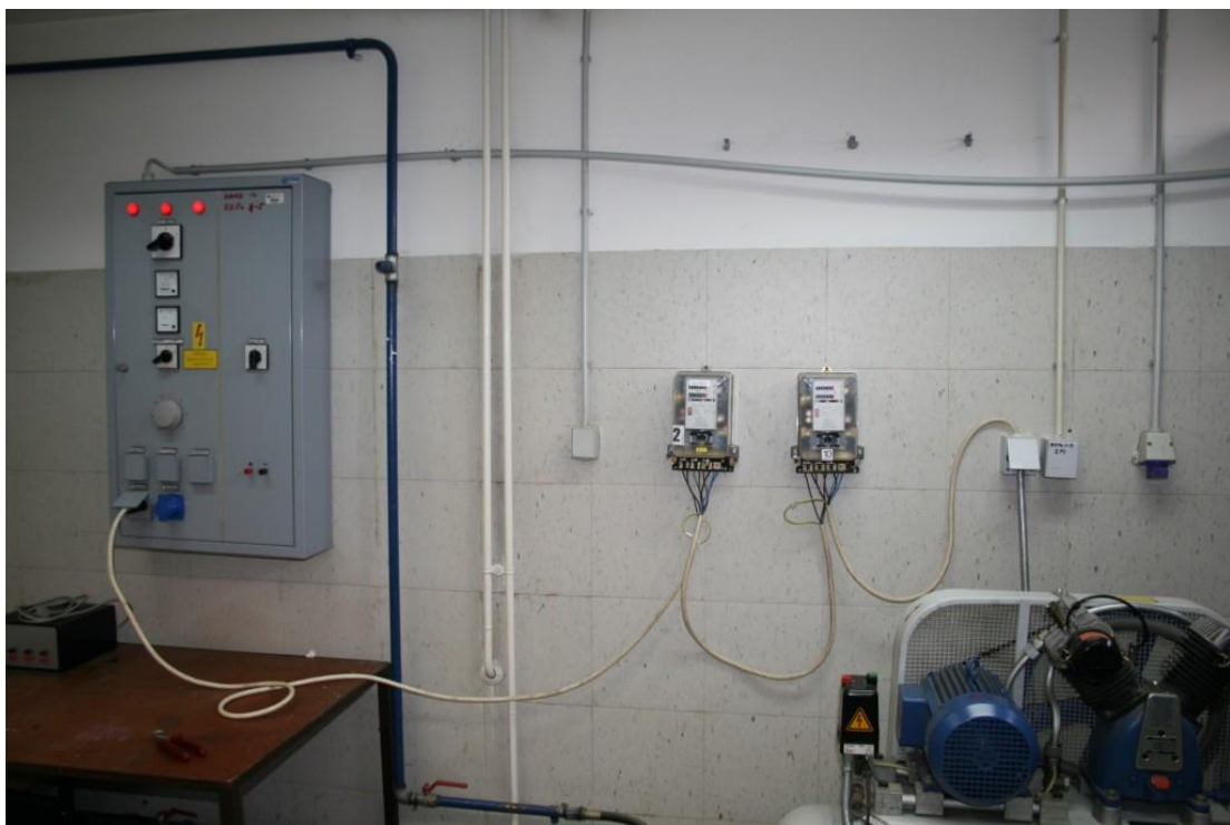
Slika 31: Ispitivanje električnih uređaja (brojila električne energije) [20].
