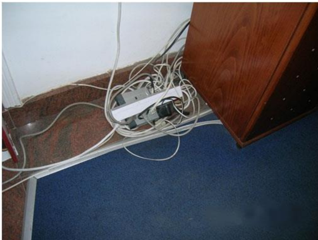
Slika 1: Prikaz neispravno priključenih produžnih kablova [12].
