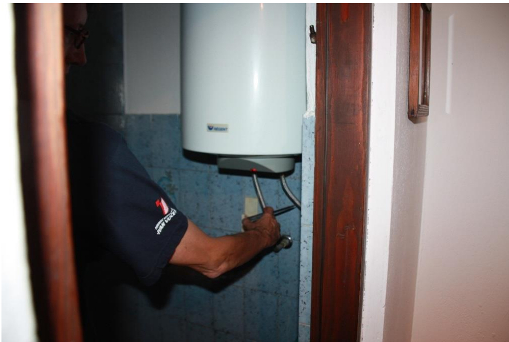
Slika 32: Ispitivanje električnih uređaja (uređaj za zagrijavanje vode) [20].
