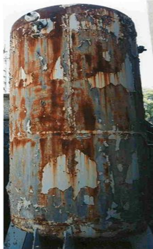
Slika 12. Primjer opće korozije vanjskih stijenki spremnika [10]
