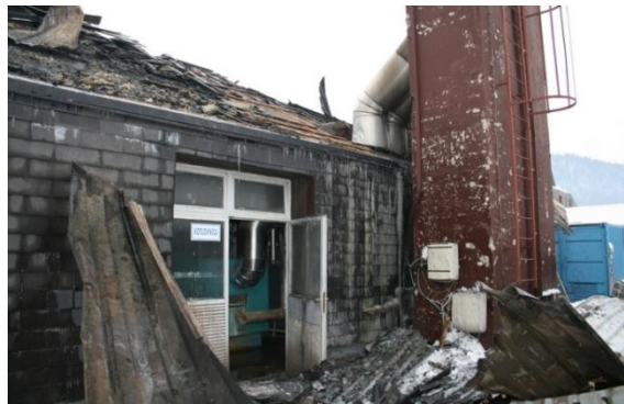
Sl.13. Potpuno izgorjeli objekt [15]
