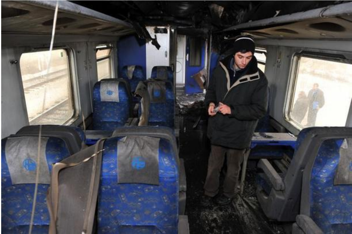
Sl. 12. Unutrašnjost putničkog vagona nakon požara [23]
