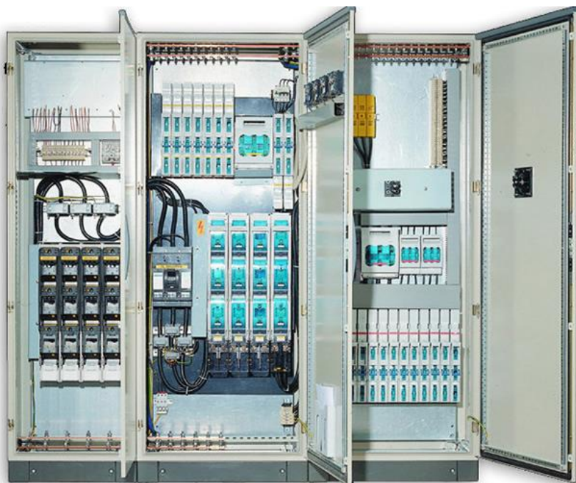
Slika 9. Ugradnjom razvodnih ormarića postiže se zaštita od izravnoga dodira [10].
