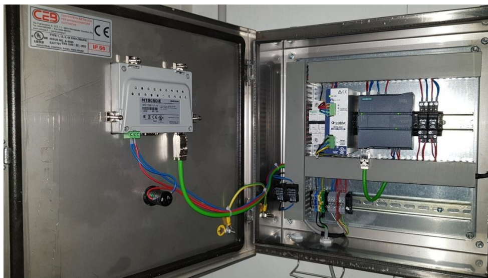
Slika 14. Elektro ormar / Autor slike 14: Antun Omrčen
