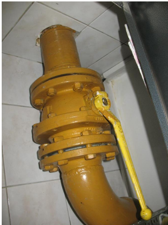
Slika 13. - Glavni zaporni ventil plinske instalacije
