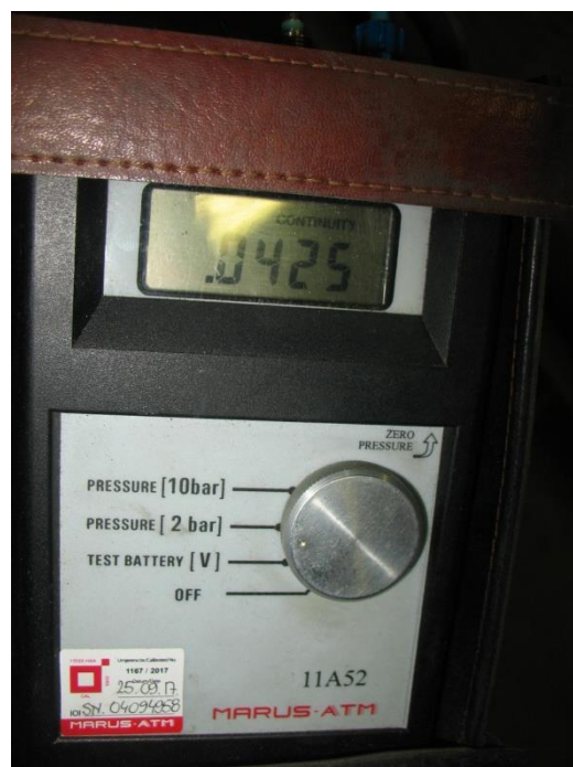
Slika 23. - Trenutna vrijednost tlaka u instalaciji
