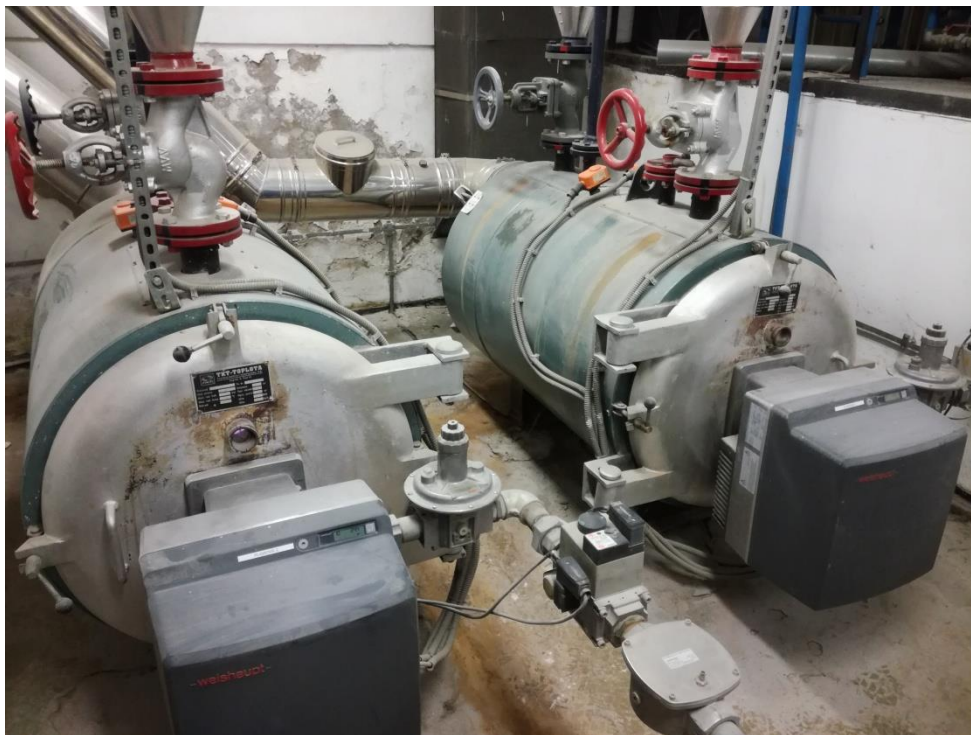
Slika 14. - Plinski kotlovi pojedinačne snage 200 kW
