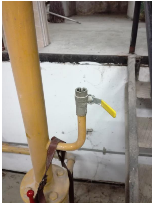
Slika 17. - Priključak za mjerni uređaj
