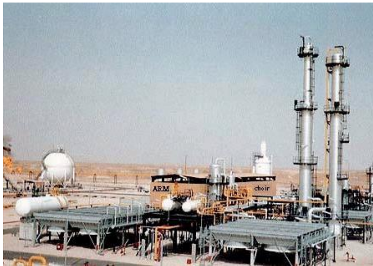
Slika 2. - Postrojenje za izdvajanje LPG iz zemnog plina
