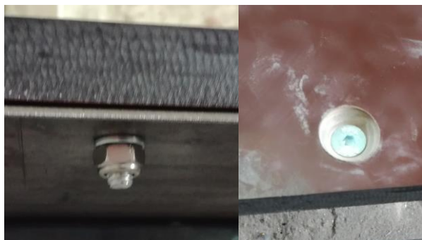
Slika 83. Stegnute ploče odozdo (lijevo) i odozgo (desno)
